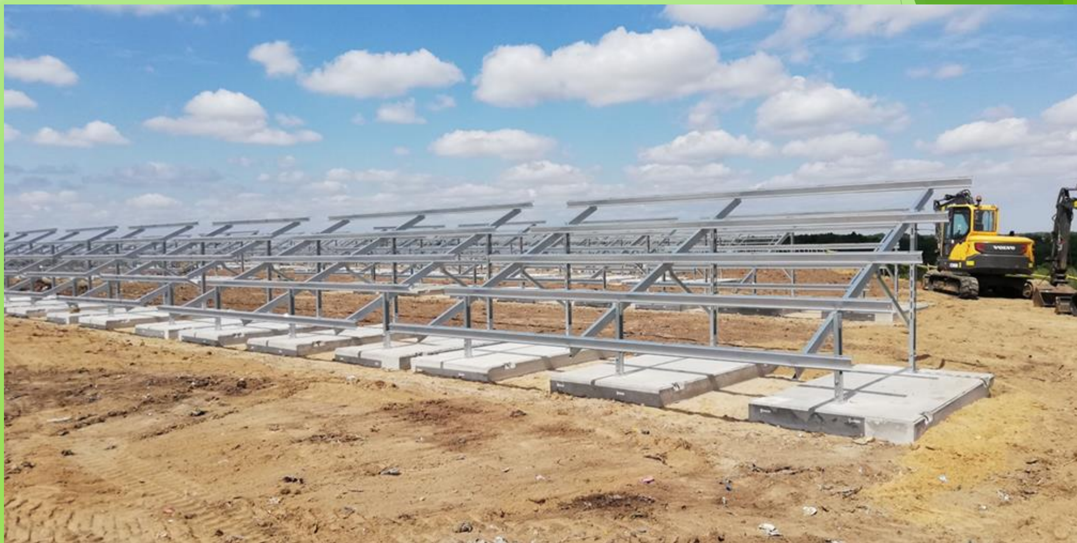
Konstrukcje wsporcze pod panele fotowoltaiczne
